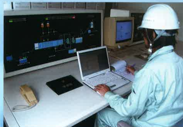
■保守管理業務 宜野座村福山浄水場
